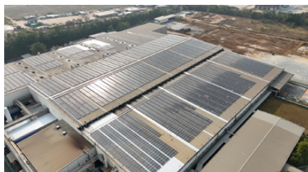
YTMTの太陽光発電設備
