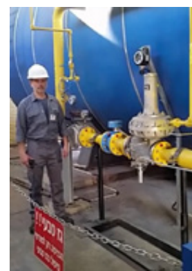
天然ガス使用機器と点検の様子
