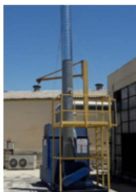
混合機の排気口の改善
