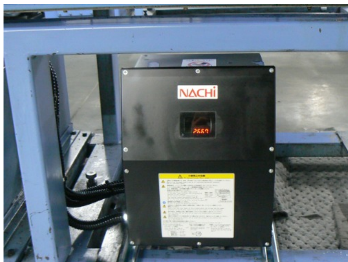
【油圧ユニット インバータ化】
