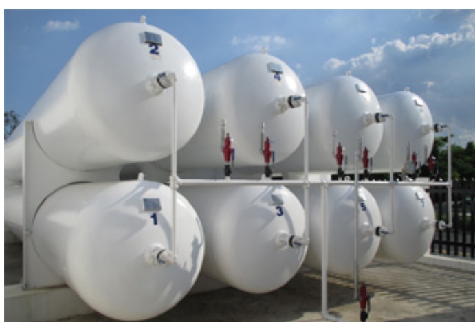
インド工場 ガスポンベへの変更
