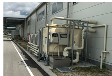
長野-水循環装置
