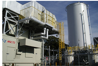
新城工場コジェネレーション
