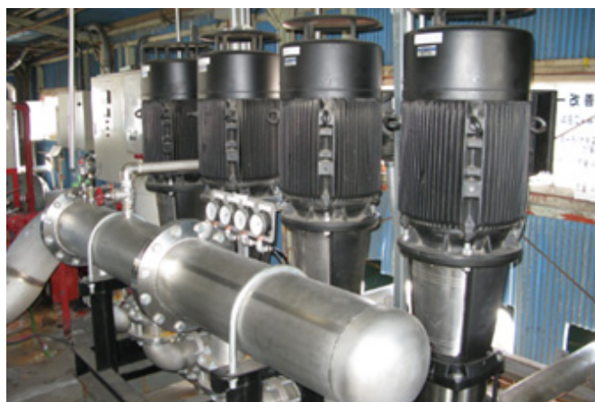
冷却水ポンプ
