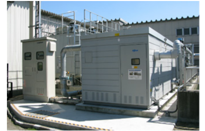
吸収式冷凍機
