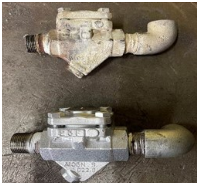
【蒸気ドレントラップ（写真上：不具合トラップ、写真下：新品トラップ）】
