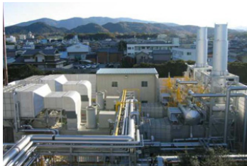
三重工場コジェネレーション
