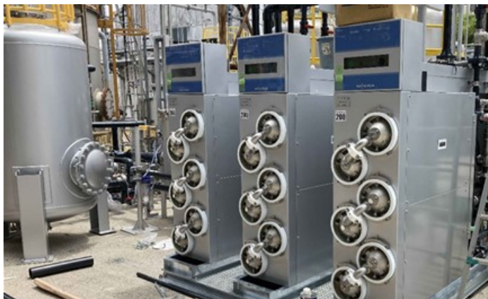
【ボイラー設備 給水システム】
