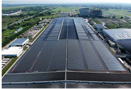
太陽光発電（フィリピン） 設備容量：4,000kw
