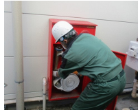
消防設備点検
