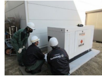
非常発電装置の点検
