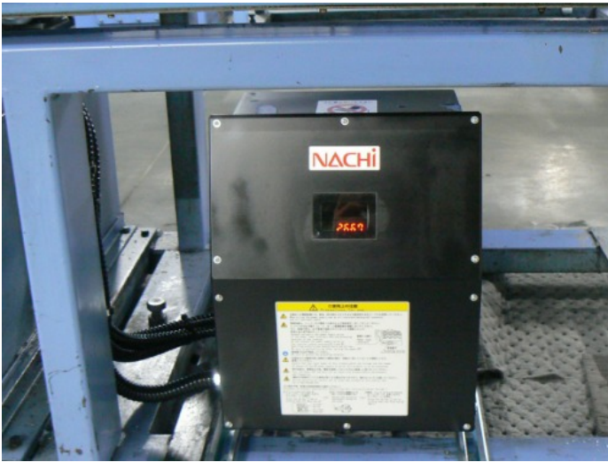
【油圧ユニット インバータ化】
