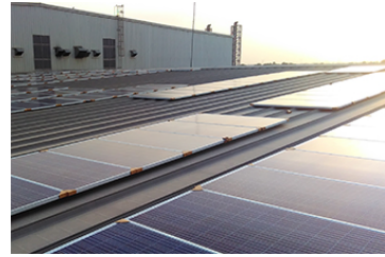
太陽光発電（インド） 設備容量：200kw
