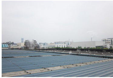
太陽光発電（中国：杭州） 設備容量：80kw
