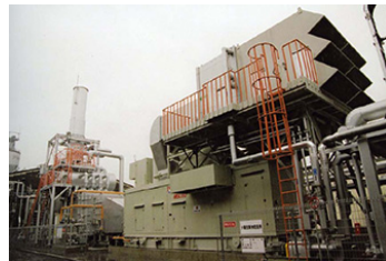
三島工場コジェネレーション
