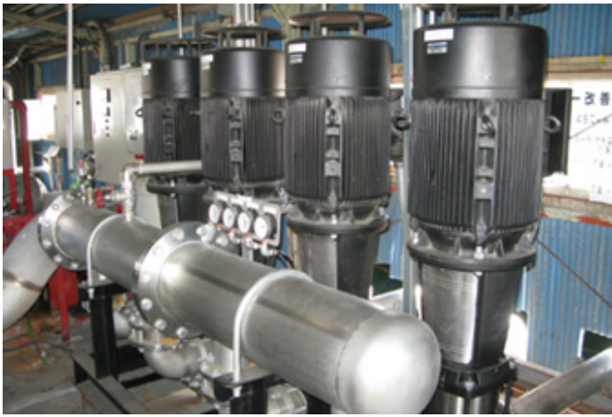
冷却水ポンプ
