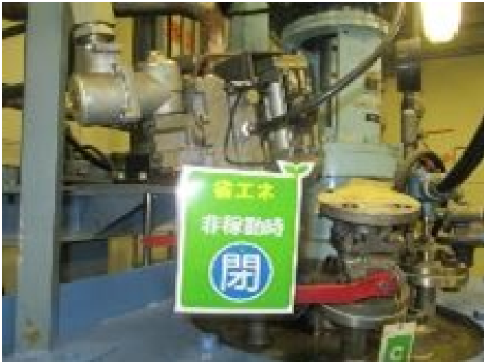
【エア元バルブ管理（非稼働時：閉）】
