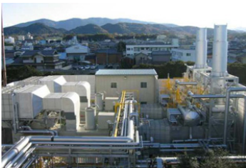
三重工場コジェネレーション
