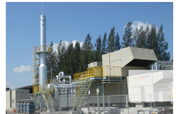
タイヤ工場コジェネレーションシステム
