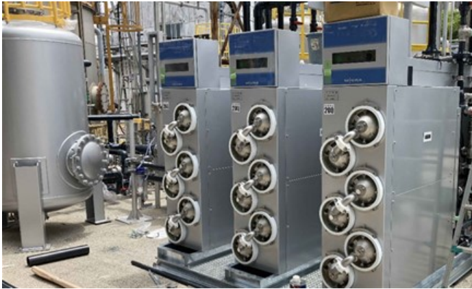
【ボイラー設備 給水システム】
