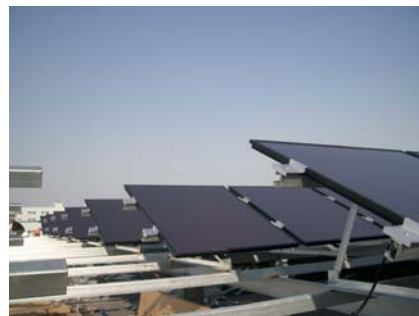
設置した太陽光パネル
