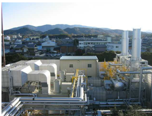
三重工場に導入したコージェネレーションシステム
