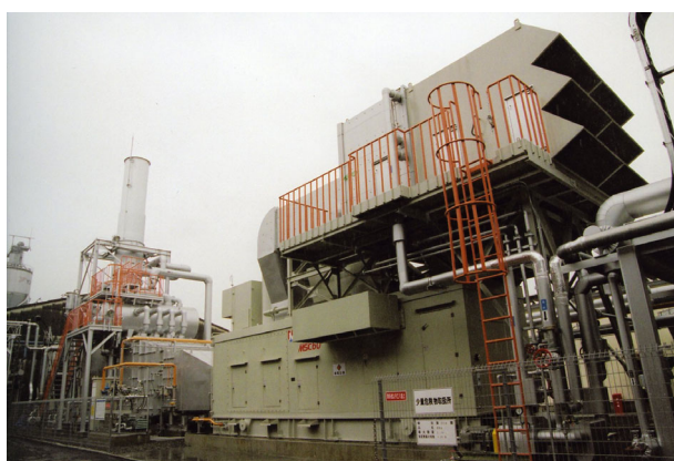
三島工場に導入したコージェネレーションシステム
