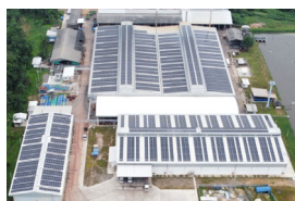
設置された太陽光発電設備
