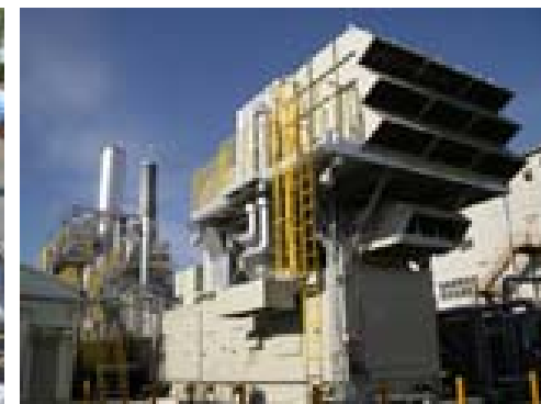
コージェネレーションシステム
