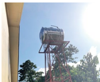
高校に新しく設置されたタンク
