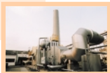
平塚製造所に設置された コージェネレーション
