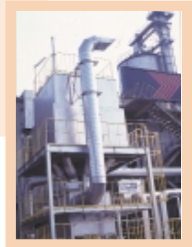
三重工場に設置された大型脱臭装置
