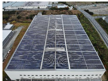
新城南工場の太陽光発電設備稼働
